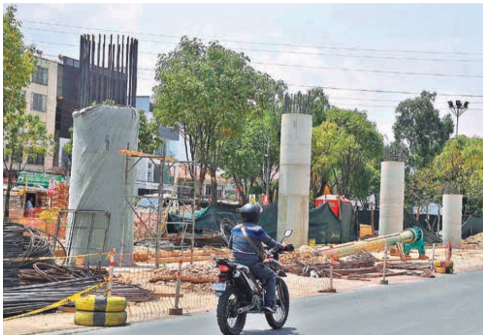
La construcción de columnas del distribuidor de la av. Perú y Blanco Galindo. C. LÓPEZ
