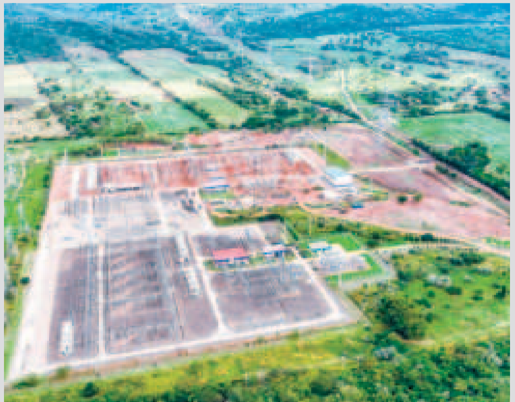
Una de las subestaciones del proyecto Carrasco-Brechas.
