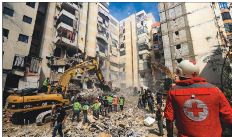
DESTRUCCIÓN. Rescatistas buscan víctimas entre los escombros.
