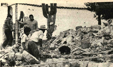
SAMAPIATA. Con recursos de CORDECruz es rehabilitado el museo regional de Samapiata, cuyas paredes interiores y exteriores se vieron abajo a causa de deficientes cimentaciones y las prolongadas lluvias de la anterior época.
