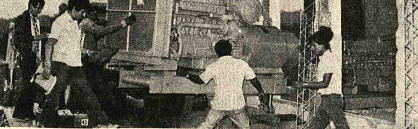
NUEVOS GENERADORES.- CORDECRUZ instala nuevos generadores de energía para el centro agroindustrial de Mañana. El complejo inició sus actividades experimentales. (Foto FRANCO para PRESENCIA).
