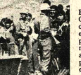
MOVIMIENTO DE TIERRAS. Las autoridades, encima de un tractor para el que llevó a Potosí la empresa SERMAQ, inician el movimiento del complejo de Karachipampa.
