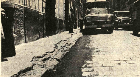
DESTROZOS.- Los vehículos pesados que circulan por la calle Murillo causan destrucción en los cordones de las aceras hasta el extremo de hacérselas desaparecer. La carga y descarga en esa arteria, sin ningún control por parte de las autoridades competentes, ocasiona embalamientos en el tránsito.
