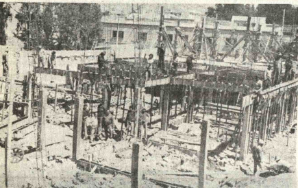
Hospital de Tupiza en actual construcción, a entregarse el 2 de diciembre; tendrá capacidad de 45 camas.
