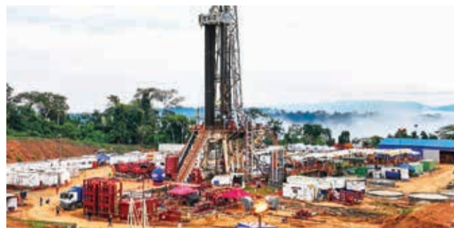
Equipos en el pozo Mayaya XI. ABI
