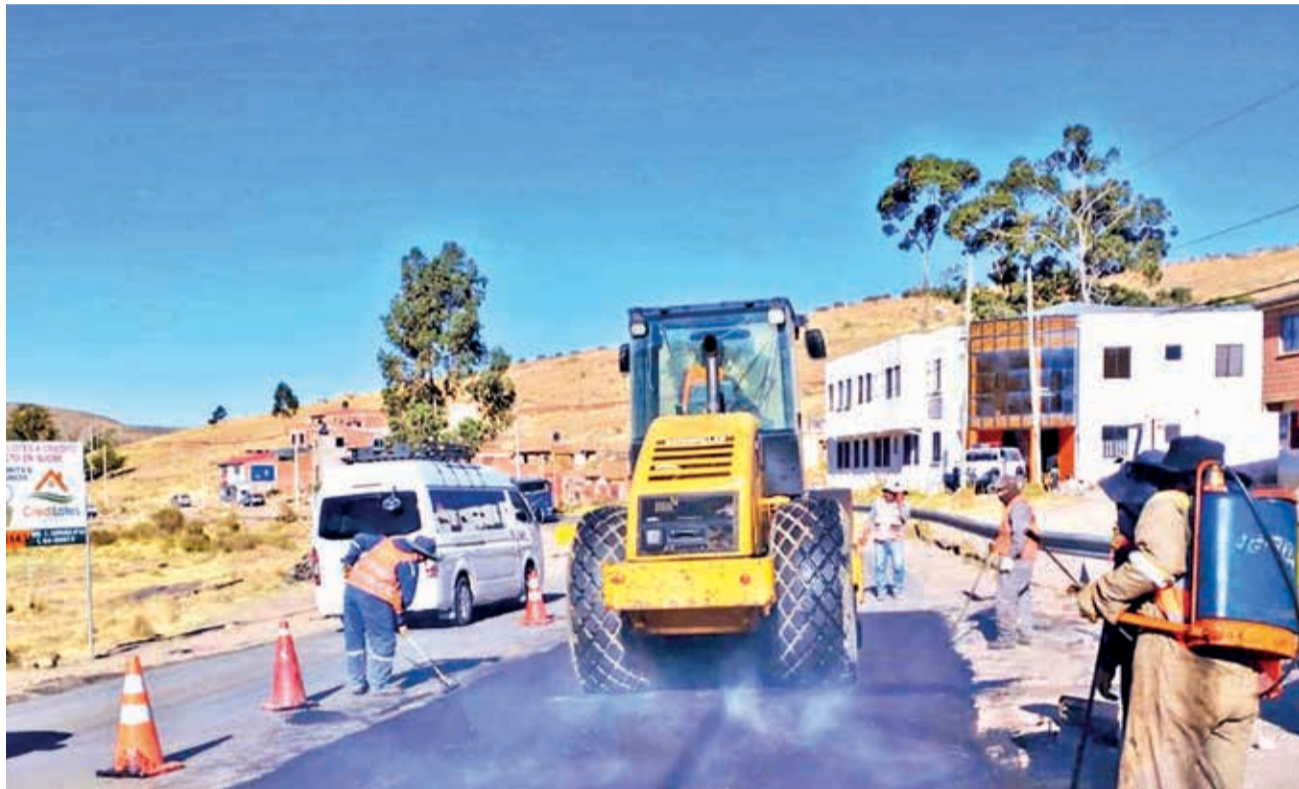
Trabajos de mantenimiento de la carretera Puente Méndez-Potosí, en el departamento de Chuquisaca. ABC
