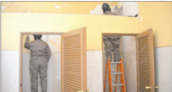
Los trabajos se vieron afectados debido al mal uso de gente inescrupulosa / LA PATRIA
