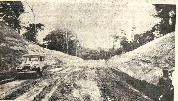
FORVENIR-CACHUELA. La fotografía muestra un aspecto del tramo caminero que se construye CORDENO en la zona Forvenir-Cachuela. Para este objeto se ha volcado todos los esfuerzos de CORDENO para vertebrar las cinco provincias de Pando con la capital Cobija.
