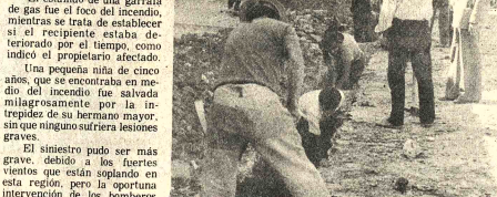
SERVICIOS. Junto a los trabajos de remodelación, se hace la instalación de servicios en el Mercado Calatayud de Cochabamba. En la foto, el tendido de la nueva red de alcantarillado.
