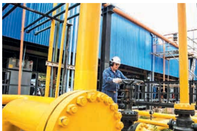
La planta de compresión de gas de Río Grande. JOSÉ ROCHA
