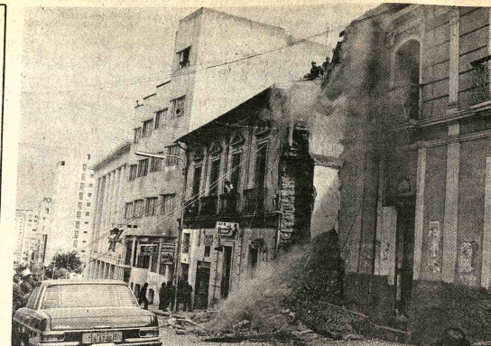
FELIGRO. En la fotografía se ve cómo los obreros de una empresa de demolición cumplen ayer a las 16.00, su finca en un vetusto edificio de la calle México de La Paz.
