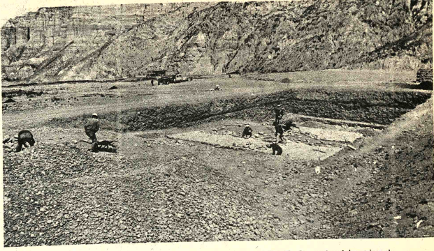
PISCINA EN ACHUMANI.- Aspecto de los trabajos iniciados por el Club The Strongest en Achumani, en el Complejo Deportivo. La foto muestra la excavación para la piscina de la entidad gualdinegra.
