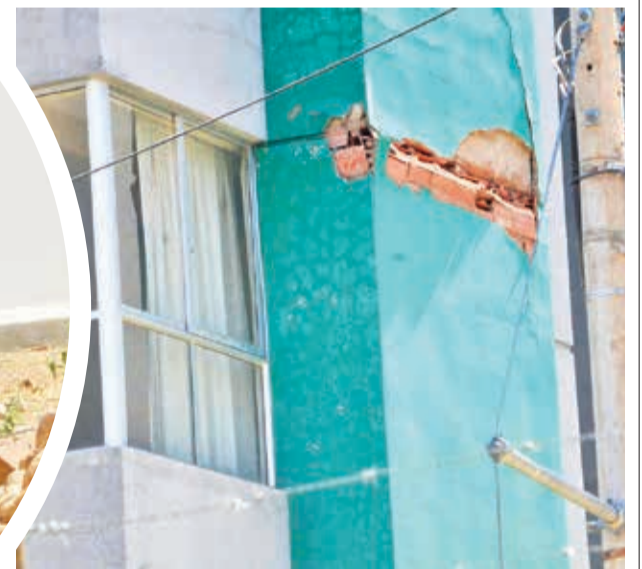
Uno de los condominios deteriorados.
