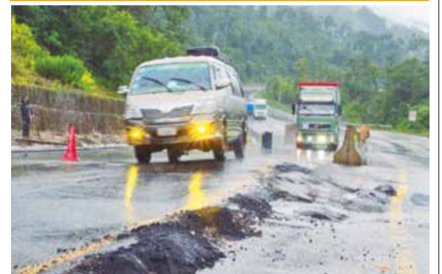
Las fallas en la doble vía El Sillar. HERNAN ANDIA
