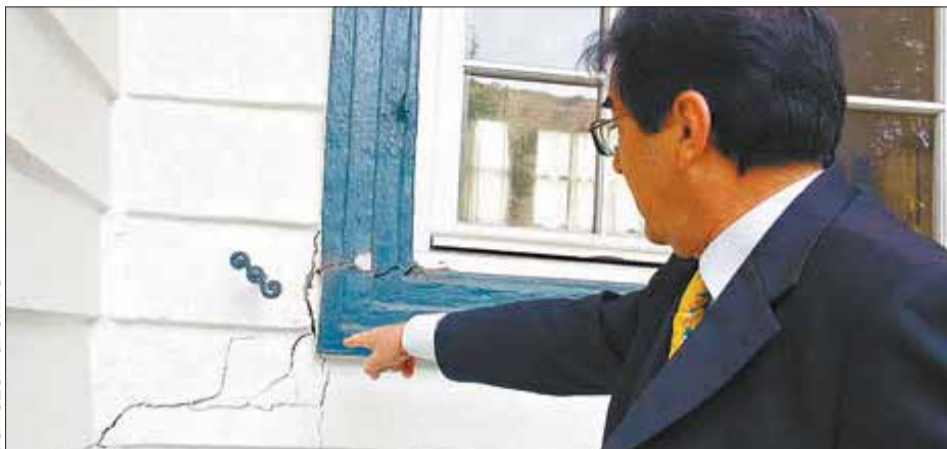
QUEJA. El exembajador de Francia, Michel Pinard, denunció en 2015 rajaduras en la casa.
