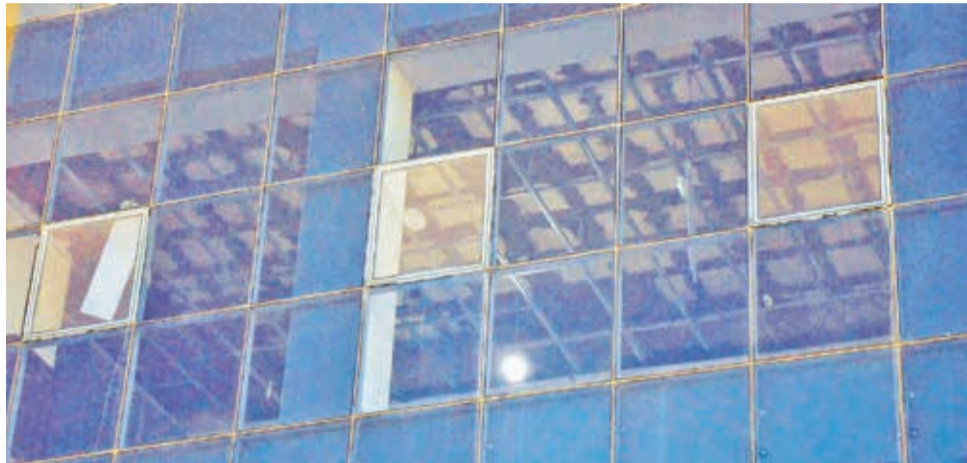
El techo del nuevo edificio se muestra afectado sin el cielorraso. FOTOS: CARLOS LÓPEZ
