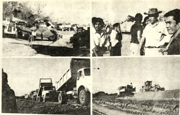
CAMINO A CHIQUITANIA. La composición gráfica fue lograda en San Julián. Arriba, a la izquierda, parte del equipo vial donado por Alemania. Al lado, el director del Proyecto "San Julián", Ing. Luis E. Rivera (con sombrero), junto a su personal. Abajo. Una columna de volquetas "M.A.N." al iniciarse los trabajos este fin de semana. Al lado. Máquinas y hombres en pleno trabajo de construcción del camino a la Chiquitania, que formará parte del proyecto Marginal de la Selva. - (FOTO PRESENCIA - SANTA CRUZ).
