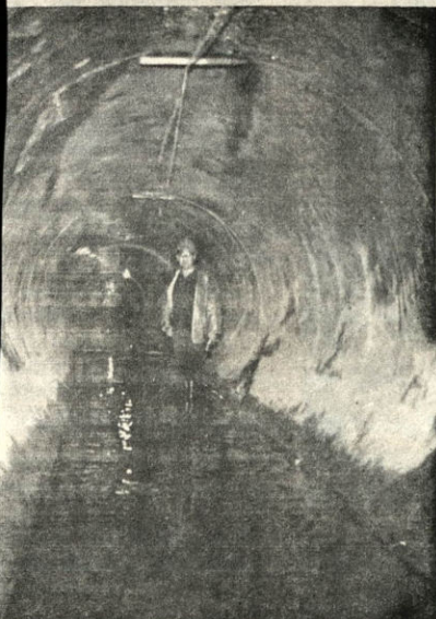
de Santa Isabel, longitud de 4.300 Mts. y diámetro de 2.20 Mts. Recubrimiento de concreto.
