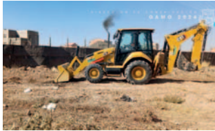
Trabajos de mejoramiento que emprende el GAMO se vieron afectados /GAMO
