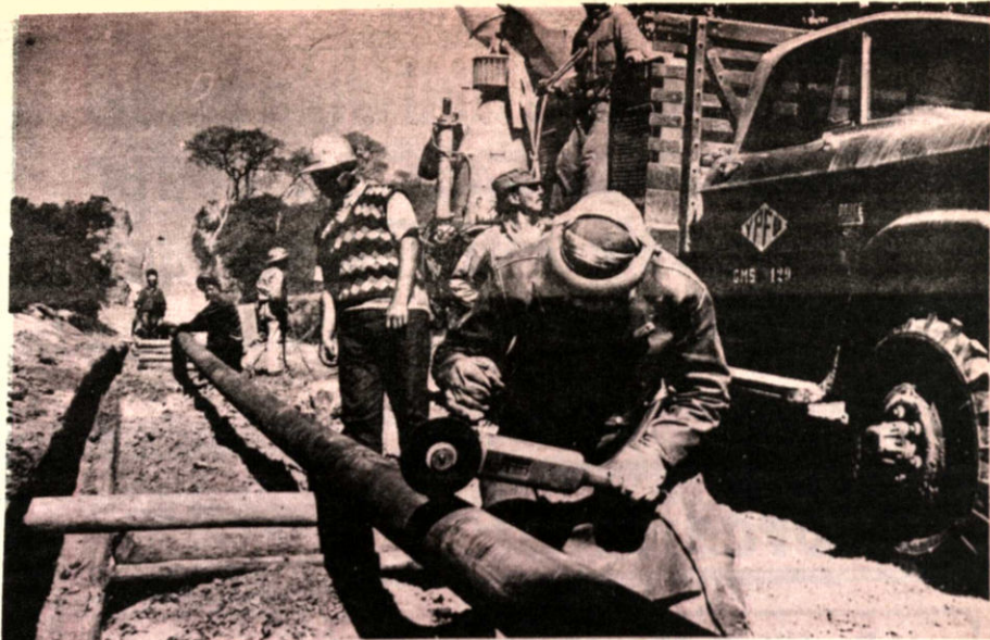
Técnicos y obreros de Yacimientos Petrolíferos Fiscales Bolivianos agilizan los trabajos de instalación del gasoducto Monteagudo-Sucre
