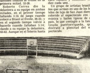
TRABAJOS EN COLISEO.—Vista de los trabajos que se efectúan en la cancha principal del Coliseo Cerrado de la calle México, para la instalación del parquet. Se estima que hasta fin de este mes podrá colocarse ese piso.
