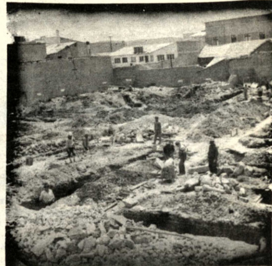
-La Cooperativa de Ahorro para la Vivienda, progreso de nuestra ciudad ha iniciado los trabajos de construcción de treinta viviendas, para igual número de socios en la zona céntrica de la ciudad.
