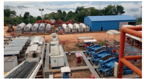
Instalaciones de Mayaya Centro-X1 en el norte de La Paz / LA PATRIA
