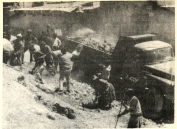
El pueblo orureño desea cooperar con la mano de obra en la solución de sus propios problemas. Ahora con la consigna de eliminar el problema Número 1, el Alcantarillado.
