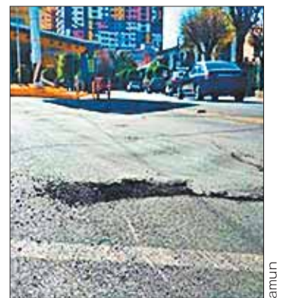
El sector afectado por el derrame.
