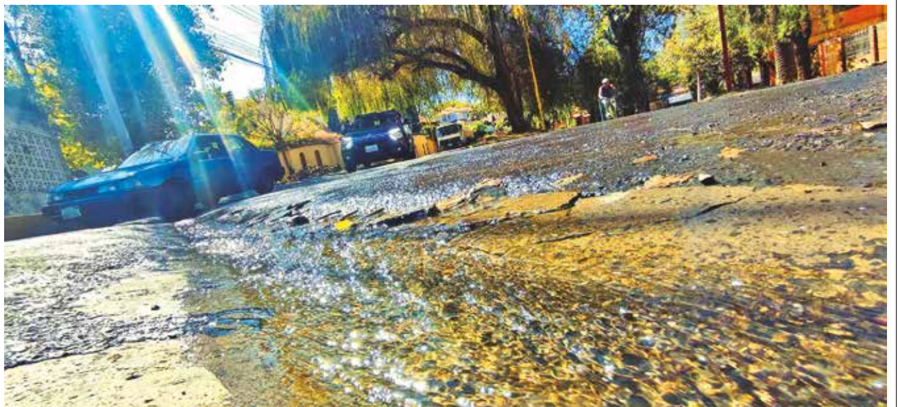
Una red de desagüe pluvial de la ciclovia que recibe las aguas freáticas de un edificio, en la zona norte.
