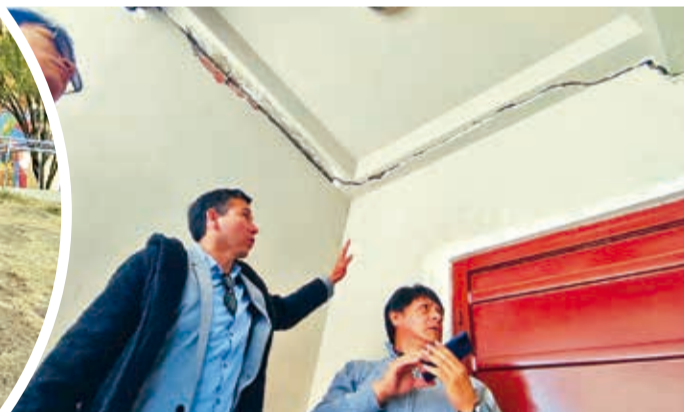
Algunos de los daños evidentes en la infraestructura.
