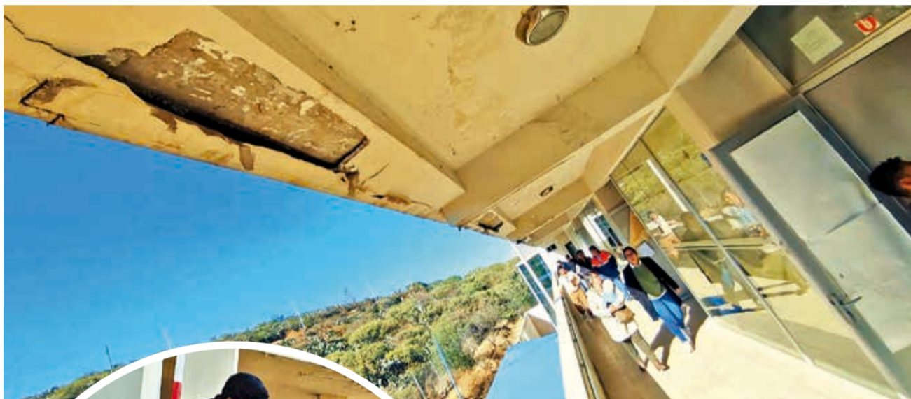
La inspección al Instituto Raúl G. Prada realizada ayer. FOTOS: D. JAMES
