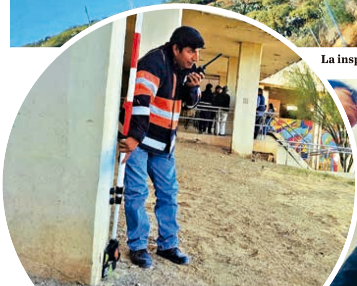
La parte sur del edificio presenta hundimientos y filtraciones.
