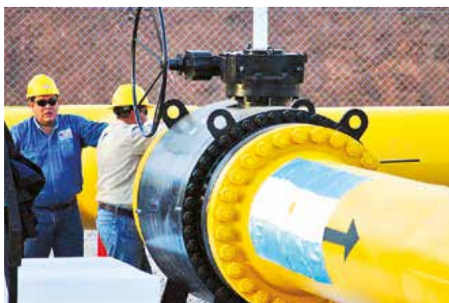
El ducto por donde se exporta gas a Argentina. LA PRENSA
