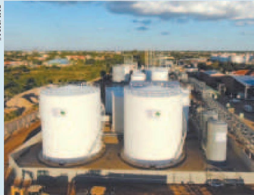
La Planta de Biodiésel I, que opera en Santa Cruz.
