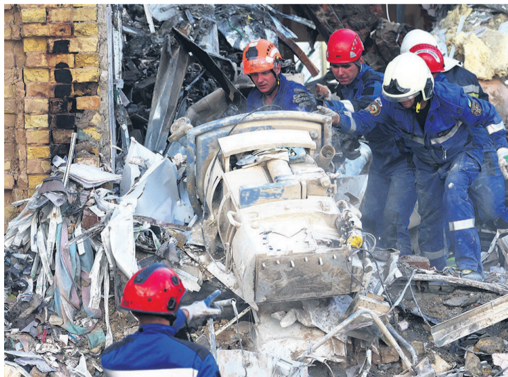
Rescatistas trabajan entre los escombros del hospital Okhmatdyt
