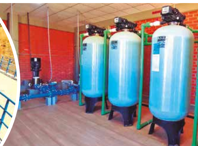
Planta potabilizadora de agua del parque.
