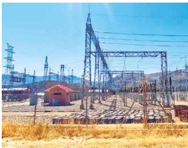
La subestación de energía eléctrica de ENDE.
