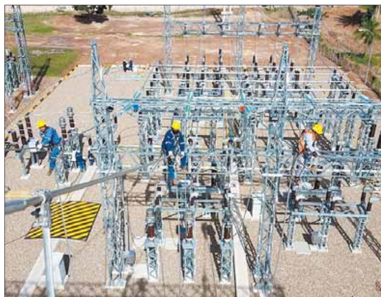
SANTA CRUZ. La Planta generadora de energía en la capital cruceña.
