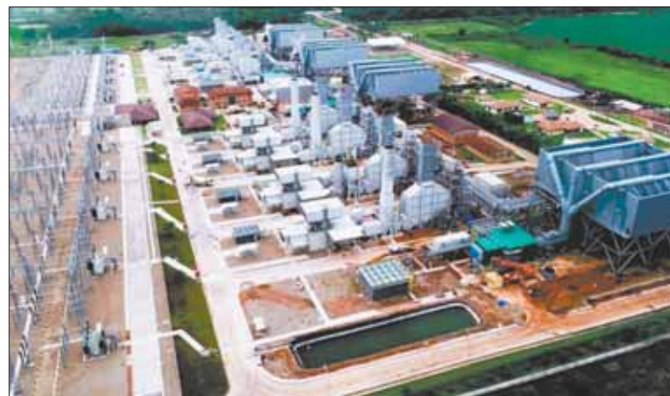
SUMINISTRO. La termoeléctrica del Sur en Tarija.
