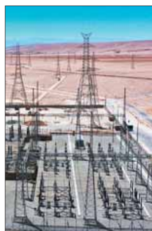
Subestación Nueva Lagunas.
