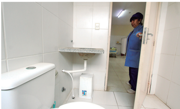
El baño dañado en el área de internación del 25 de Diciembre
