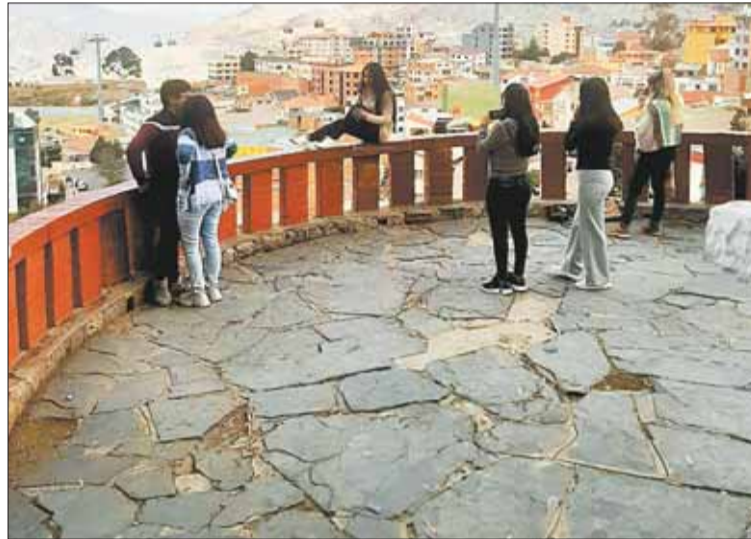
PELIGRO. El Montículo, donde el piso está destruyéndose.
