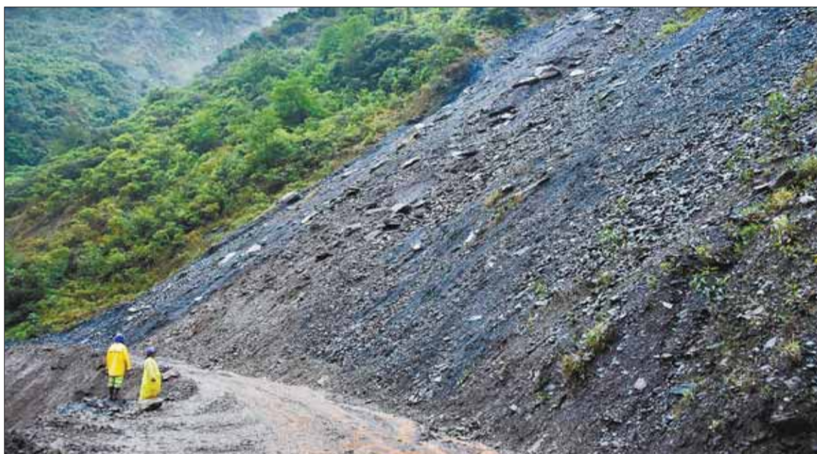
SEGURIDAD. Un camino hacia el norte de La Paz, que en época de lluvias se vuelve intransitable por las lluvias.
