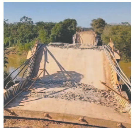
El colapso del puente del río Rapulo /CAPTURA
