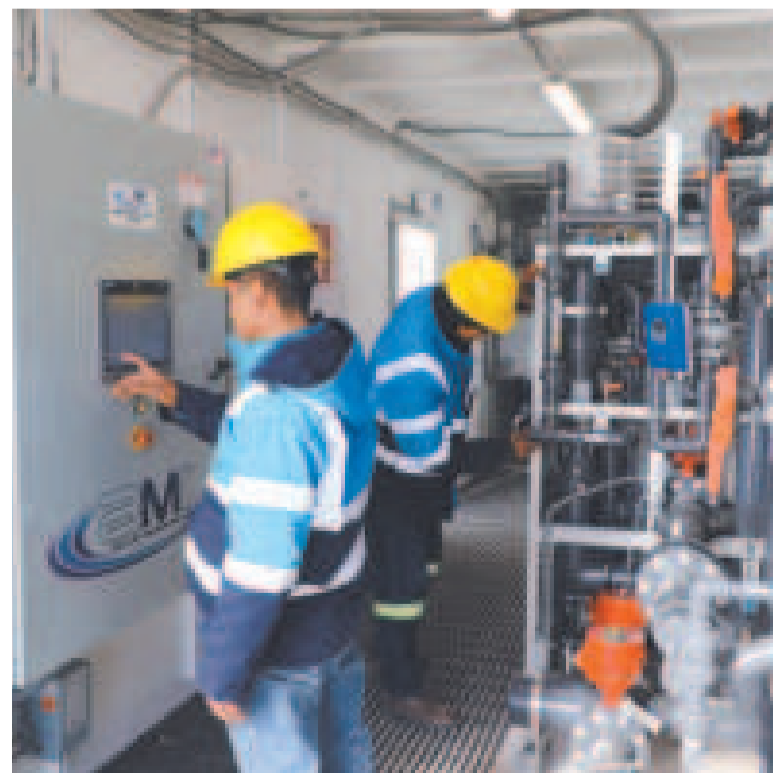
Personal de YLB en la Planta de Tratamiento de Agua.
