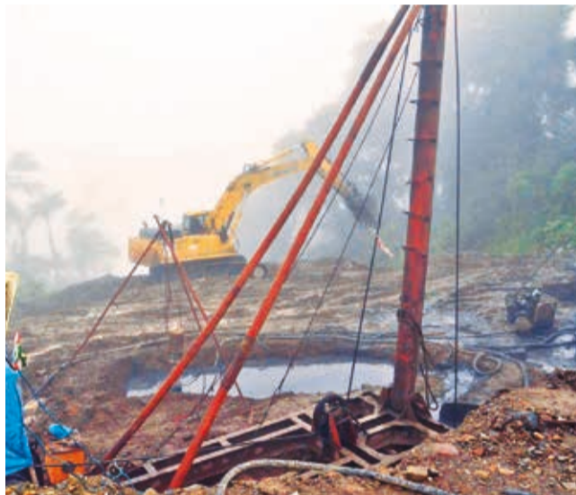
Deterioro en un sector de la doble vía El Sillar. HERNÁN ANDÍA
