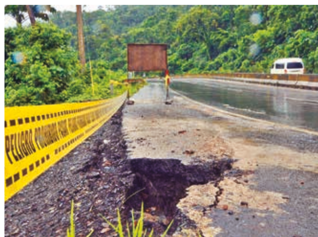
Caída de plataforma cerca del puente Thiyu Mayu.
