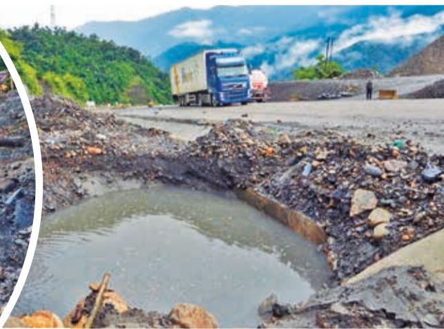
Agua estancada en un canal de drenaje.
