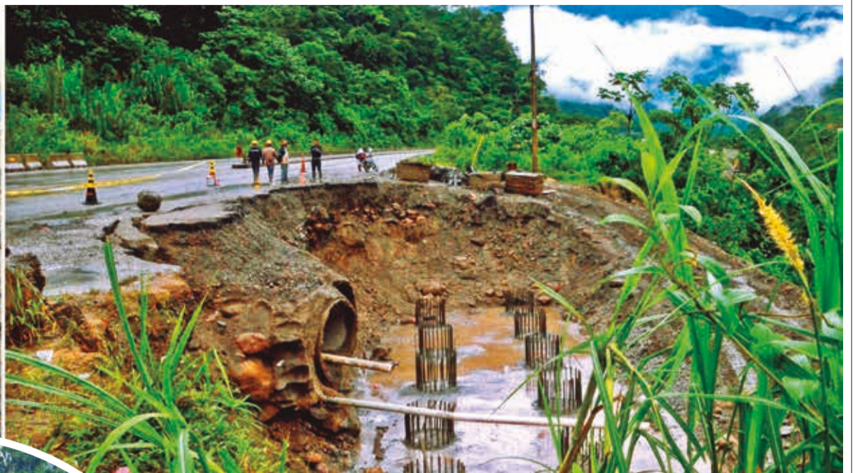
Perforación para colocar un pilote (izquierda) y caída de la plataforma en el km 128. FOTOS: HERNAN ANDIA
