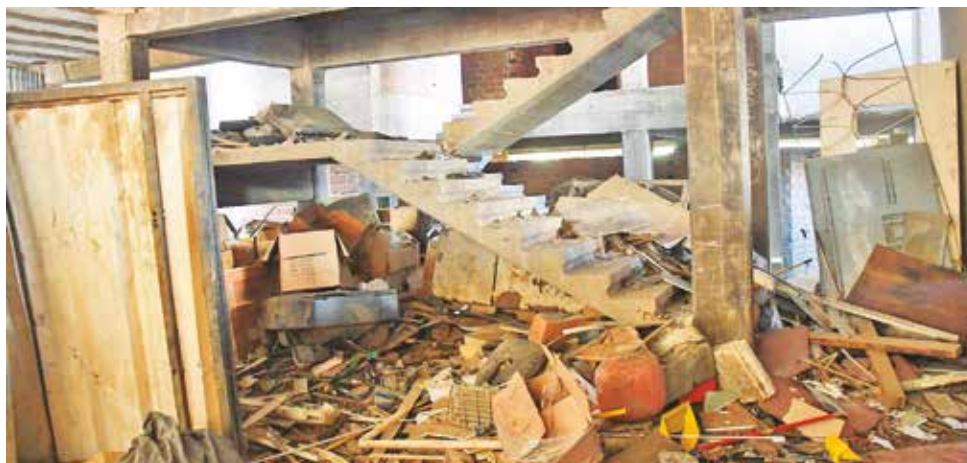
La obra del hospital abandonada y deteriorada después de 10 años de dejadez. C. LÓPEZ
