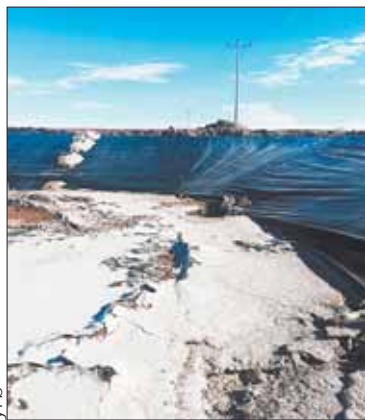
Una de las piscinas dañadas.
