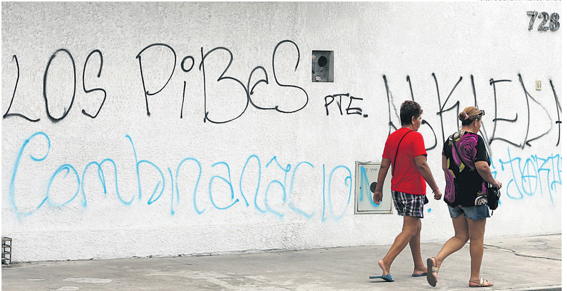
DAÑOS OCASIONADOS. Las paredes quedan sucias y los propietarios deben invertir en el constante pintado de sus fachadas, por eso piden que las autoridades establezcan castigos para los infractores
