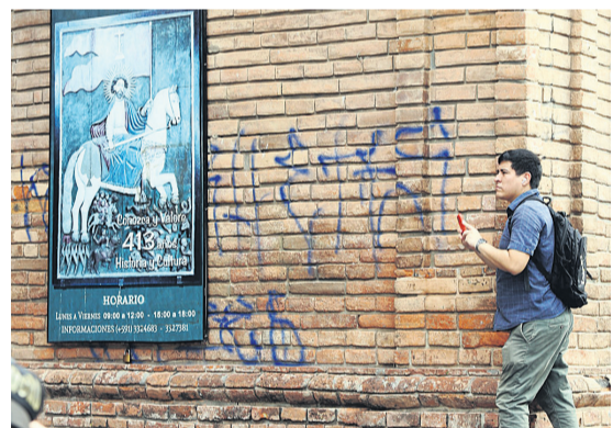
LA CATEDRAL CRUCEÑA. La obra religiosa más emblemática también tiene las marcas en sus paredes
