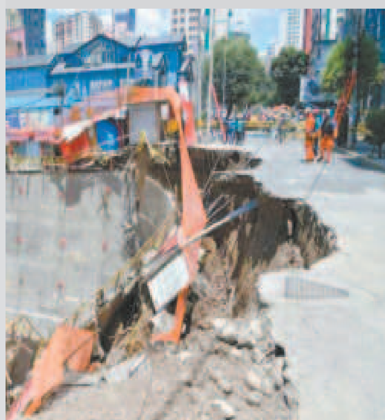
El desplome de un muro y una plataforma hicieron intransitable una parte de Sopocachi.
