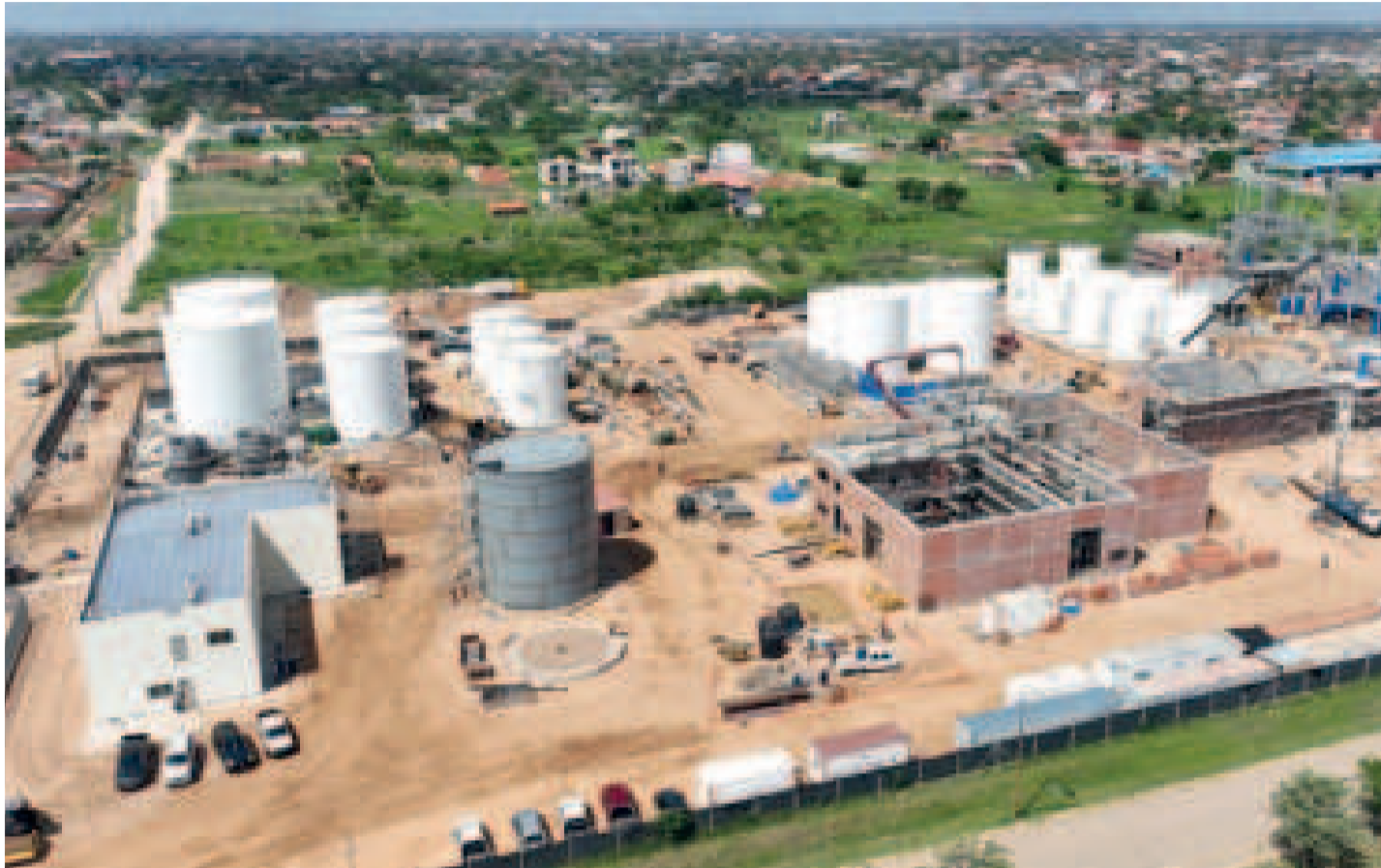
La Planta de Biodiésel 1 está ubicada en predios de la Refinería Guillermo Elder Bell, en Santa Cruz.
