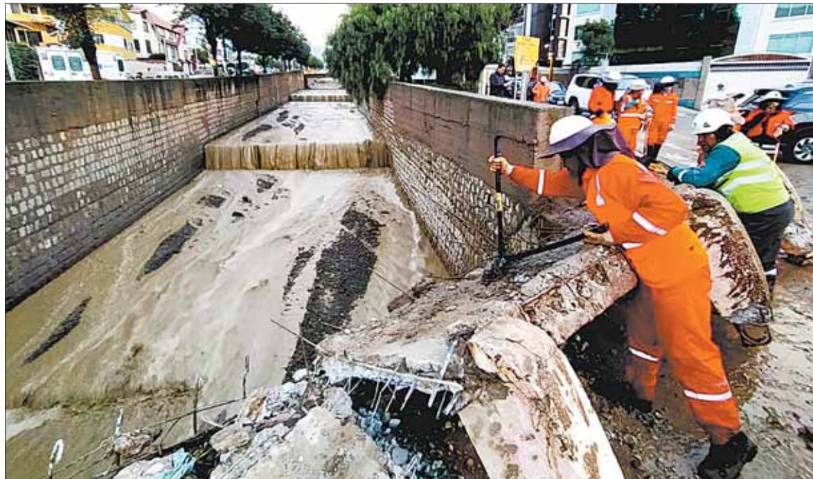
DESASTRE. El puente de ingreso al barrio de La Florida quedó afectado debido al desborde del río.
