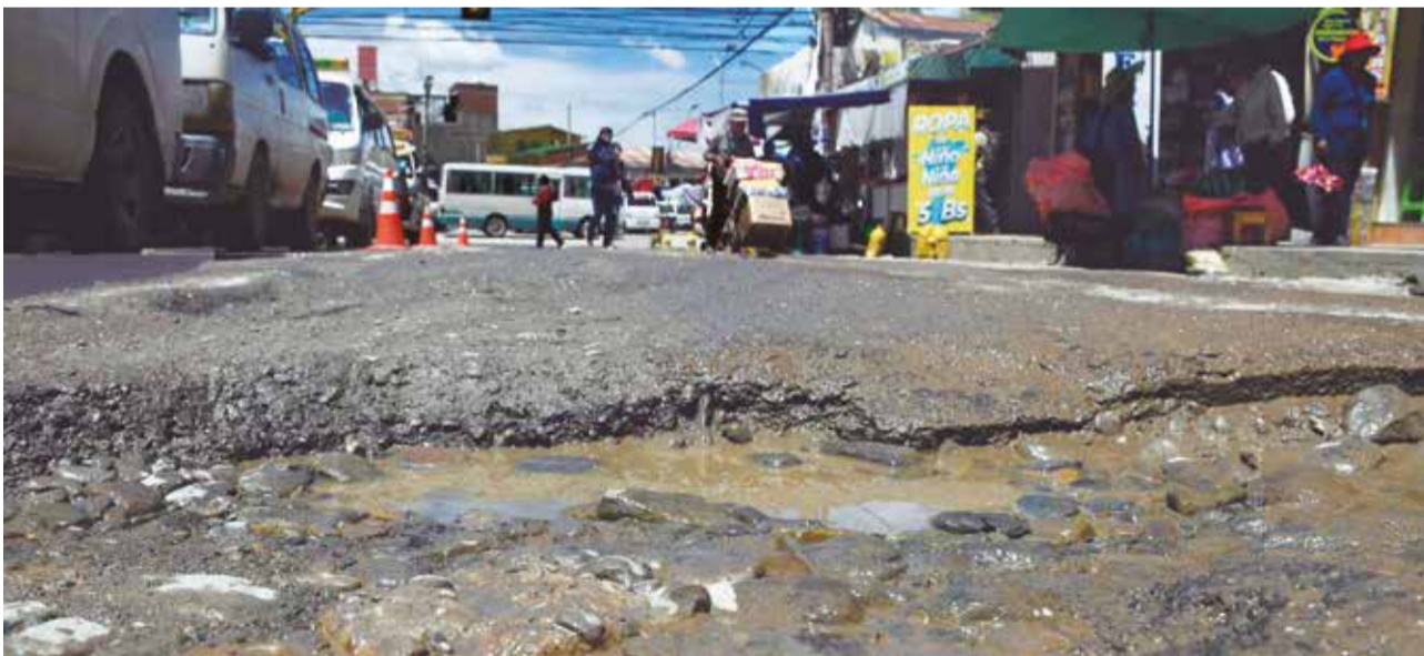
Los baches inundan la avenida Santa Cruz, una de las vías troncales en la zona norte del municipio.
