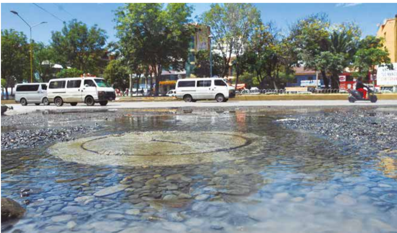
El colapso de alcantarillado por lluvias deterioran el asfalto de la calle 23 de Marzo en Quillacollo. FOTOS: CARLOS LÓPEZ
