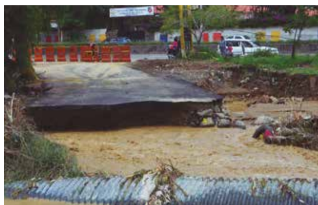
El puente provisional destruido, ayer en la Uyuni.
