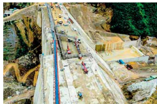
Parte de la hidroeléctrica Ivirizu. ENDE
