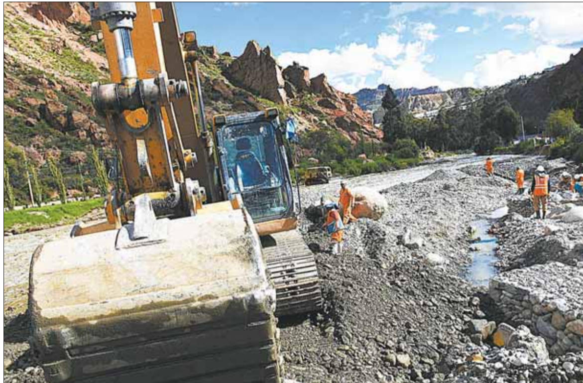
PROBLEMAS. Varios desbordes de ríos ya se han presentado en el sur del municipio de La Paz.
